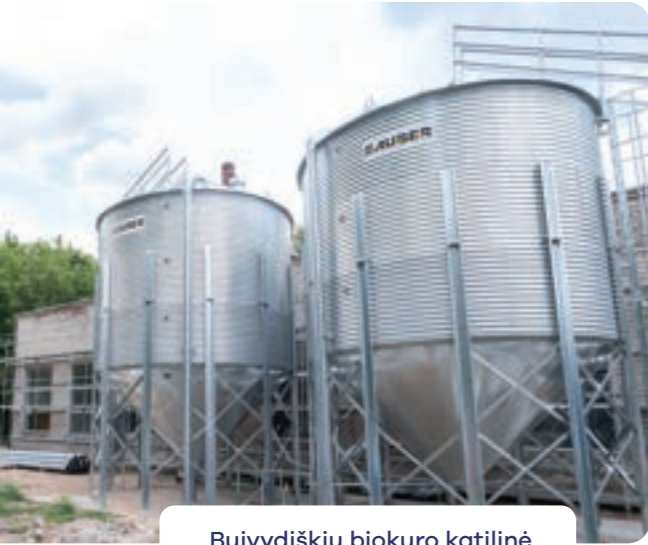
Buivydžiškių biokuro katilinė
